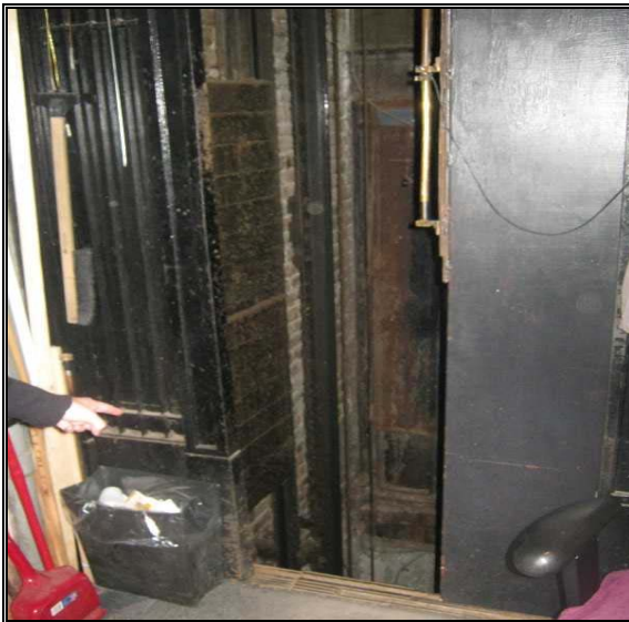
Porte arrière du monte-charge ouverte Source : CSST
