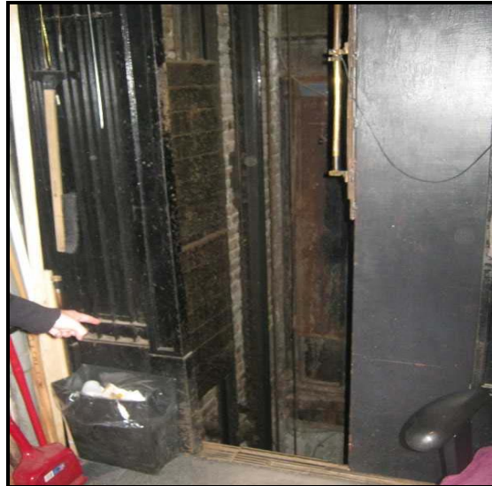
Porte arrière du monte-charge ouverte au local du travailleur (Source : CSST)
