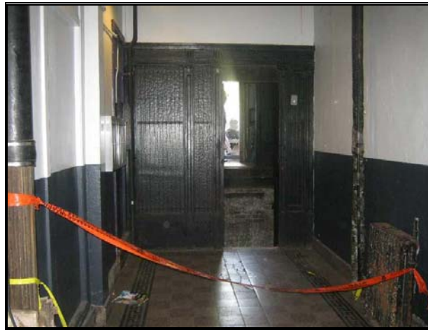
Porte palière du monte-charge ouverte au rez-de-chaussée (Source : CSST)
