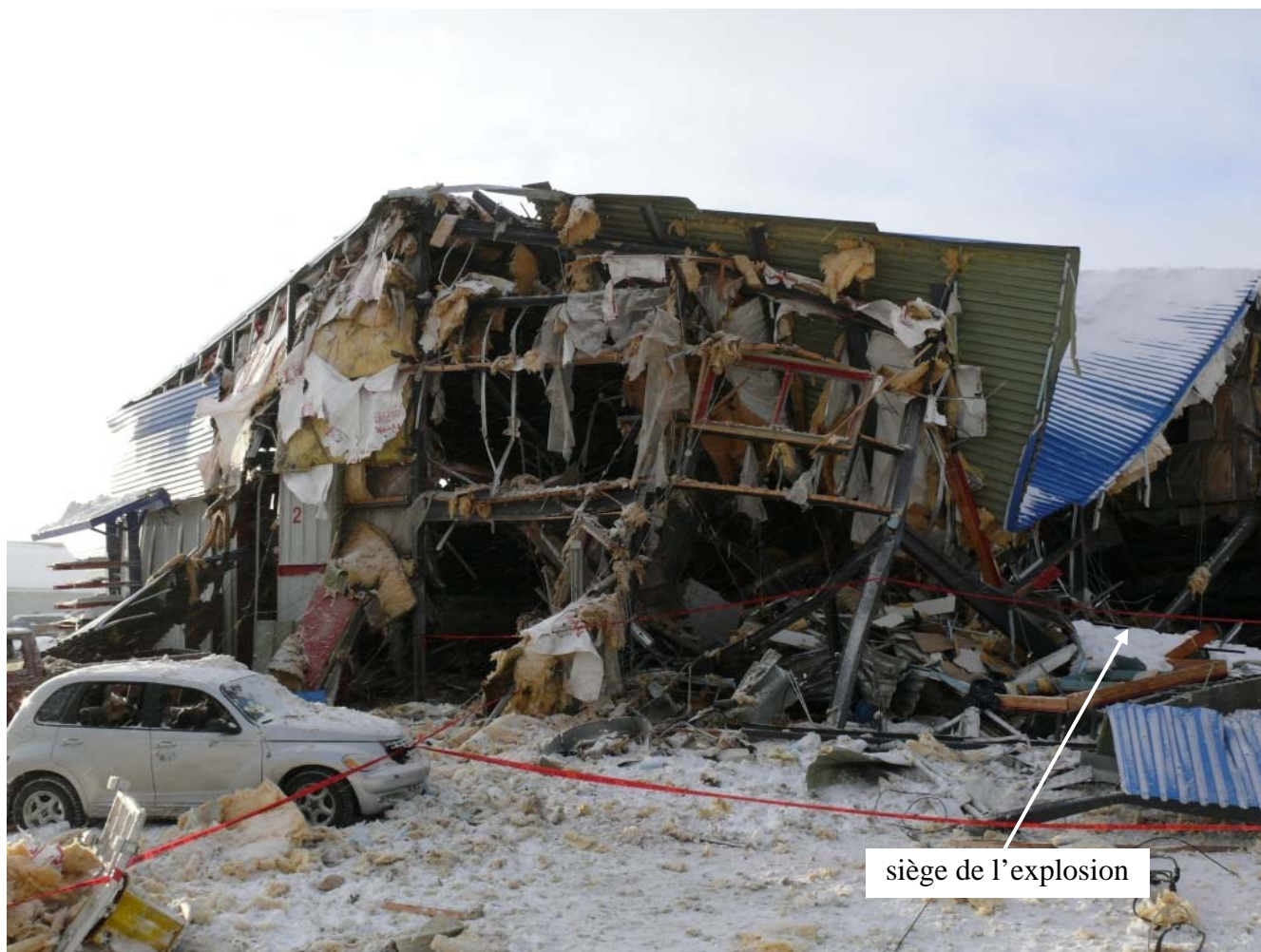
Vue de la partie avant du bâtiment endommagée par l'explosion
